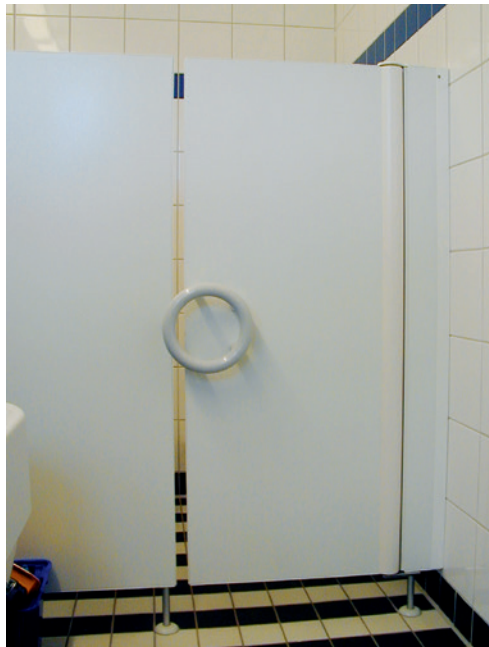
Foto 17: Kabinentür im Sanitärbereich ohne Quetschstellen
