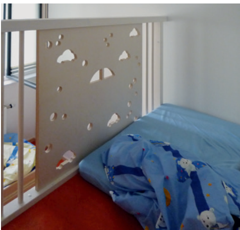
Foto 24: Umwehung einer Spielebene mit unzulässigen Öffnungen, weil diese ein Beklettern der Brüstung ermöglichen
