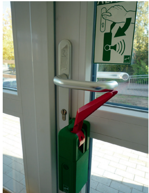
Foto 15: Fluchtweg mit Sicherung
