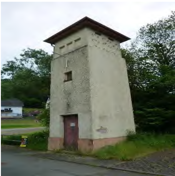
Abb. 47: Trafoturm am Brühlplatz
