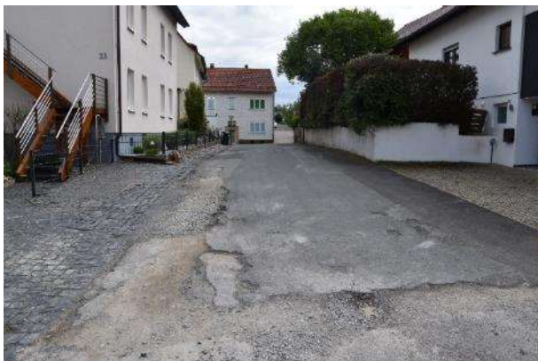
Abbildung 54: Erhebliche Straßenschäden in der Straße Am Rain
