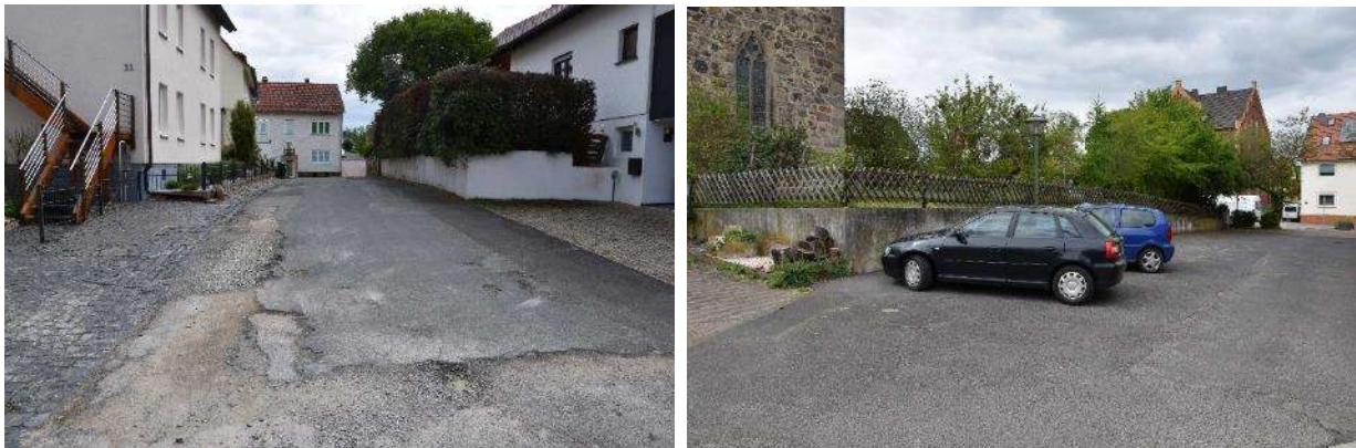
Abbildung 28: Oberflächenschäden und funktionale Beeinträchtigungen in der Straße Am Rain (links) und in der Kirchgasse (rechts)
