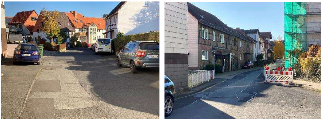
Abbildung 30: Oberflächenschäden der Anliegerstraßen im Plangebiet
