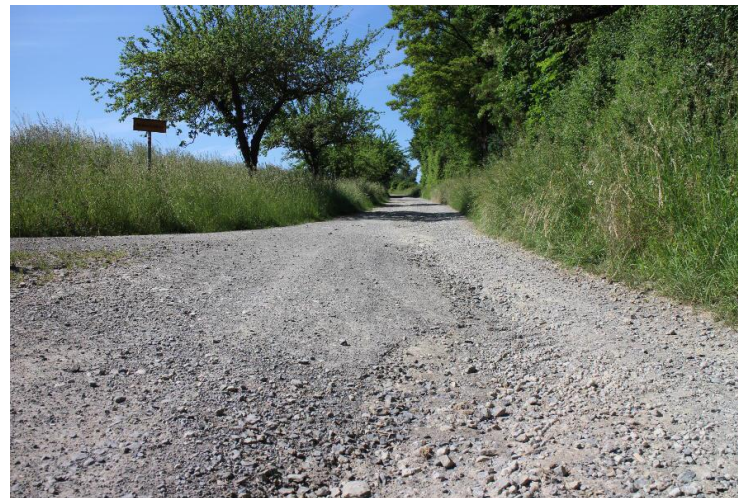
Blick bergwärts auf die Auswaschungen mit losem Schotter.
