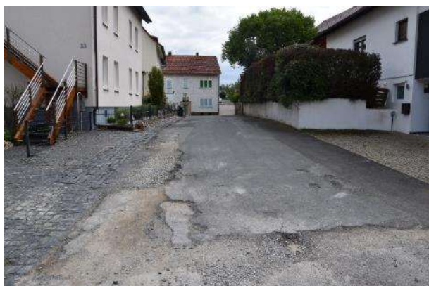
Abbildung 54: Erhebliche Straßenschäden in der Straße Am Rain
