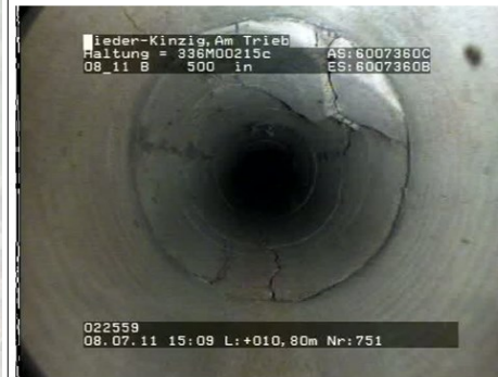
Haltung 336M00211 einragende Rohrscherbe, Einsturzgefahr (Statik)
