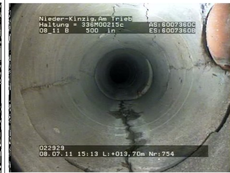
Haltung 336M00211 Scherbenbildung 1/4-Risse, Einsturzgefahr (Statik)
