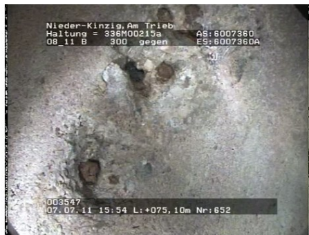
Haltung 336M00213 Korrosion, punktueller Lochfraß
