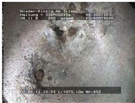
Haltung 336M00213 Korrosion, punktueller Lochfraß
