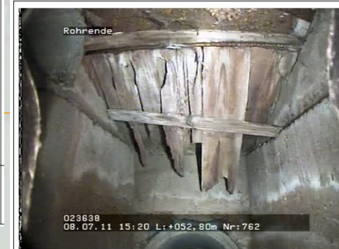
Schacht 6007360B (aus Richtung 6007360C – Blick in Flr.) Bauzustand marode, muss erneuert werden
