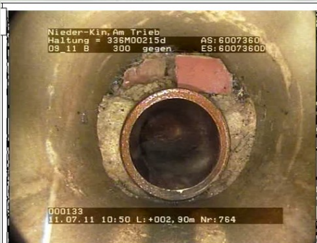
Schacht 6007360H (kein Schacht vorhanden) Übergang zu Wohnhaus 13 nicht fachgerecht
