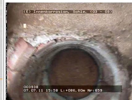
Schacht 6007360A Metallplatte, Schacht verdeckt Bauzustand marode, muss erneuert werden
