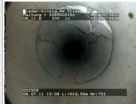
Haltung 336M00211 einragende Rohrscherbe, Einsturzgefahr (Statik)
