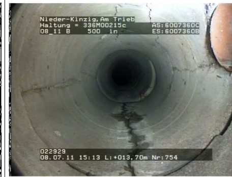
Haltung 336M00211 Scherbenbildung ¼-Risse, Einsturzgefahr (Statik)
