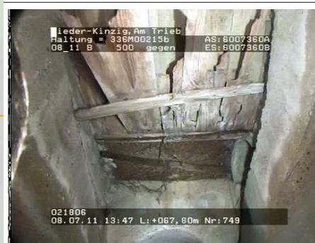
Schacht 6007360B (aus Richtung 6007360A – Blick gegen Flr.) Bauzustand marode, muss erneuert werden
