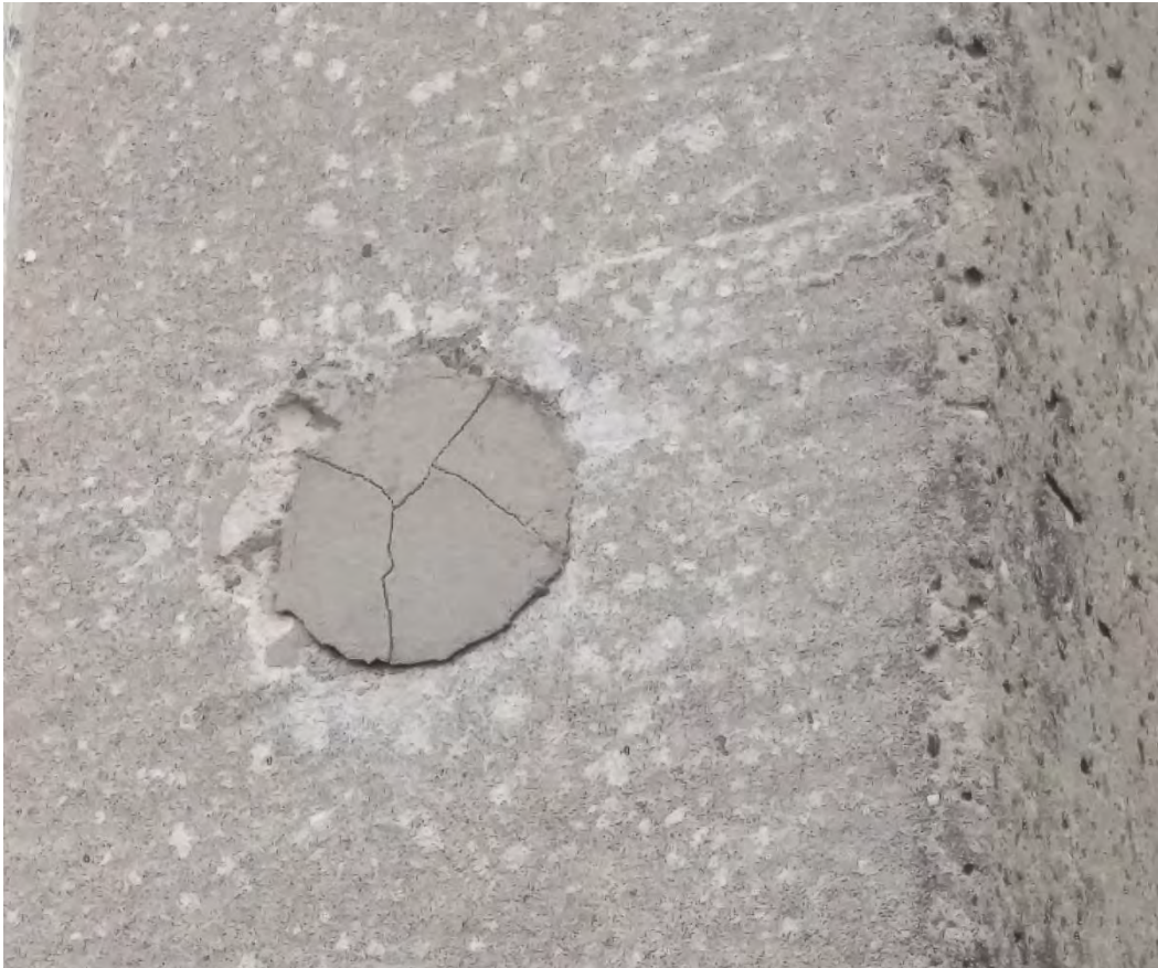
Abbildung 6 nachträglich verschlossene Öffnungen
