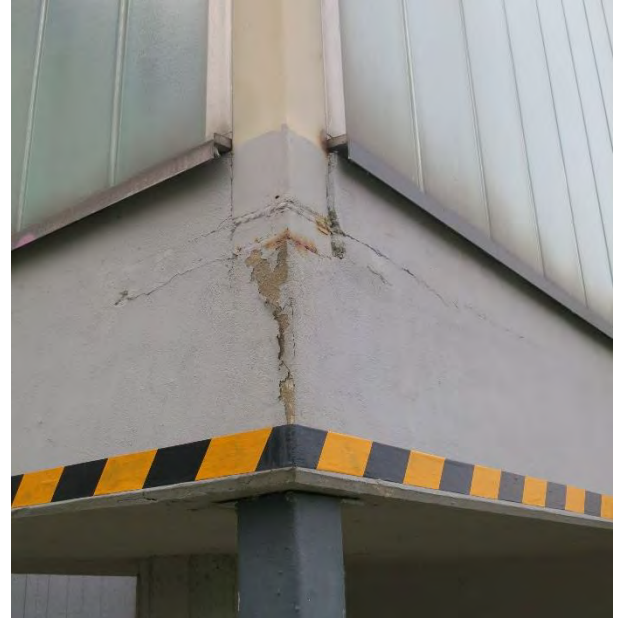
Abbildung 7 Risse an der Fuge Rohbeton, Aufbeton
