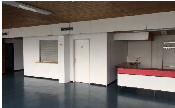
Der Kiosk (Leichtbauwände) wird von den Vereinen genutzt. Der darüberliegende Lüftungskanal ist mit der Tribüne verbunden.
