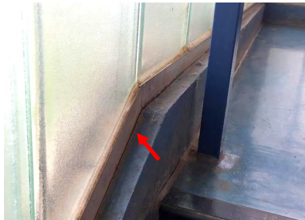
Die Silikonfugen der Alu-Anschlussprofile sind rissig.
