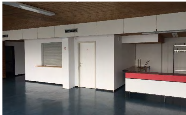
Der Kiosk (Leichtbauwände) wird von den Vereinen genutzt. Der darüberliegende Lüftungskanal ist mit der Tribüne verbunden.
