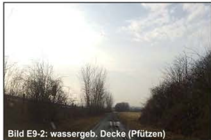
Bild E9-2: wassergeb. Decke (Pfützen)
