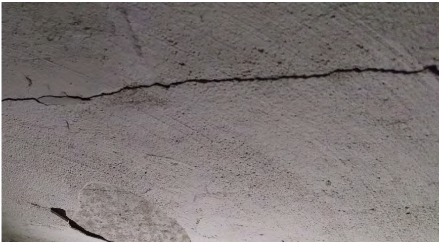
Abbildung 9 Riss in Fuge von Stahlbetonfertigteilen
