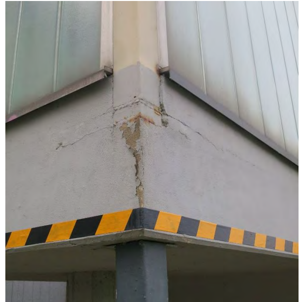
Abbildung 7 Risse an der Fuge Rohbeton, Aufbeton
