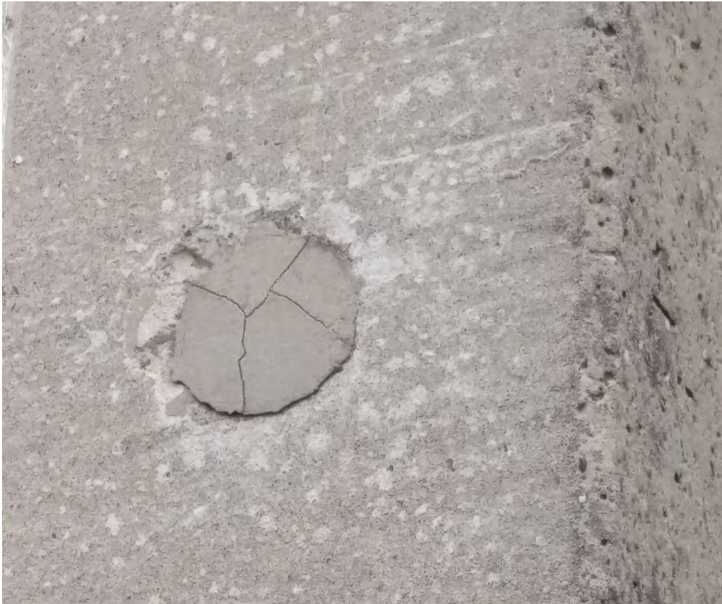
Abbildung 6 nachträglich verschlossene Öffnungen
