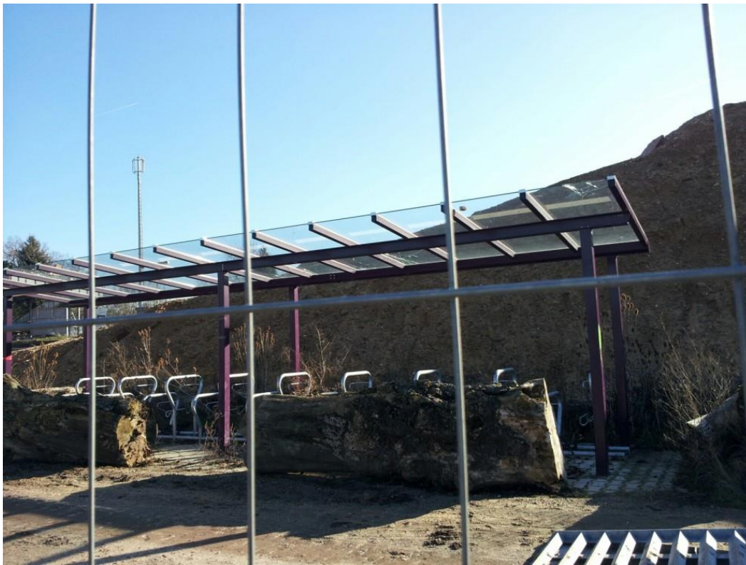
Bild # 4: Elemente der Glasplattenbedachung bereits mit Glasbruchstellen aufgrund Baubetriebs
