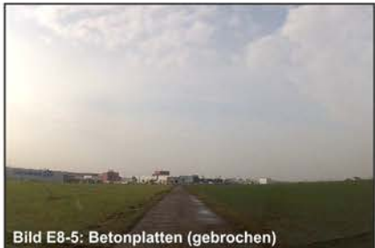
Bild E8-5: Betonplatten (gebrochen)
