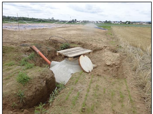
Abb. 13: Pump- und Kontrollschacht der Pflanzenkläranlage
