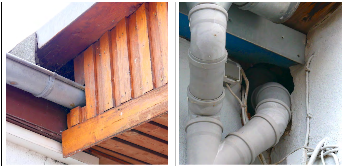
Abbildung 5: Dachstöße mit unvollständig geschlossenen Fassaden im Bereich Mitte-Ost
