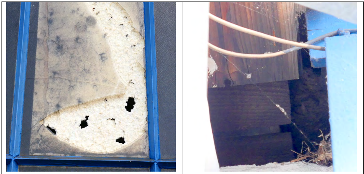
Abbildung 6: Provisorische Fensterreparatur mit Meisenbearbeitung, Nischennest unter Dachanschluss Mitte-Ost
