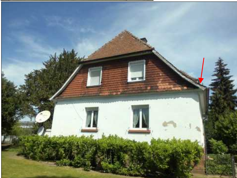
Foto 3: Diese Nachkriegsvilla wird vom Hausmeister bewohnt und bietet Fledermäusen reichlich Verstecke und ggf. Wochenstuben. Auch ein Meisenpaar zog gerade unterm Dach Junge hoch. Pfeil. 03.06.2022-HGF
