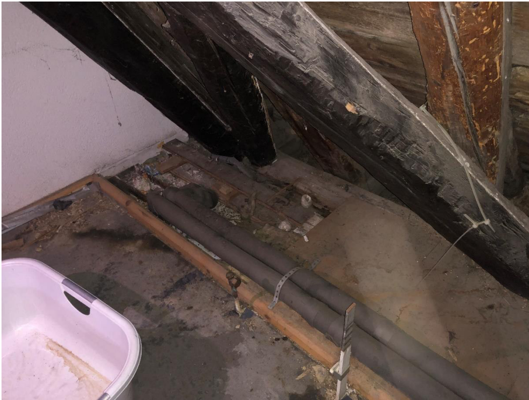
Heizleitung für gelben Saal
