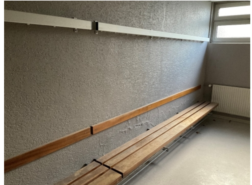
Umkleidebereiche mit Schäden aus von unten aufsteigender Feuchte
