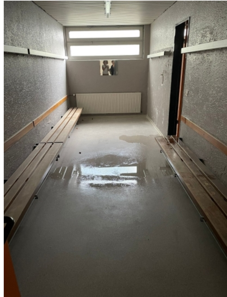
Umkleide 1 mit Wassereintritt durch das Dach
