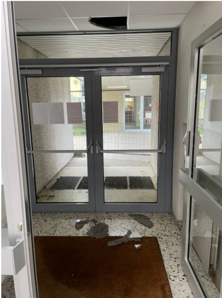
Eingangsbereich mit Wassereintritt durch das Dach
