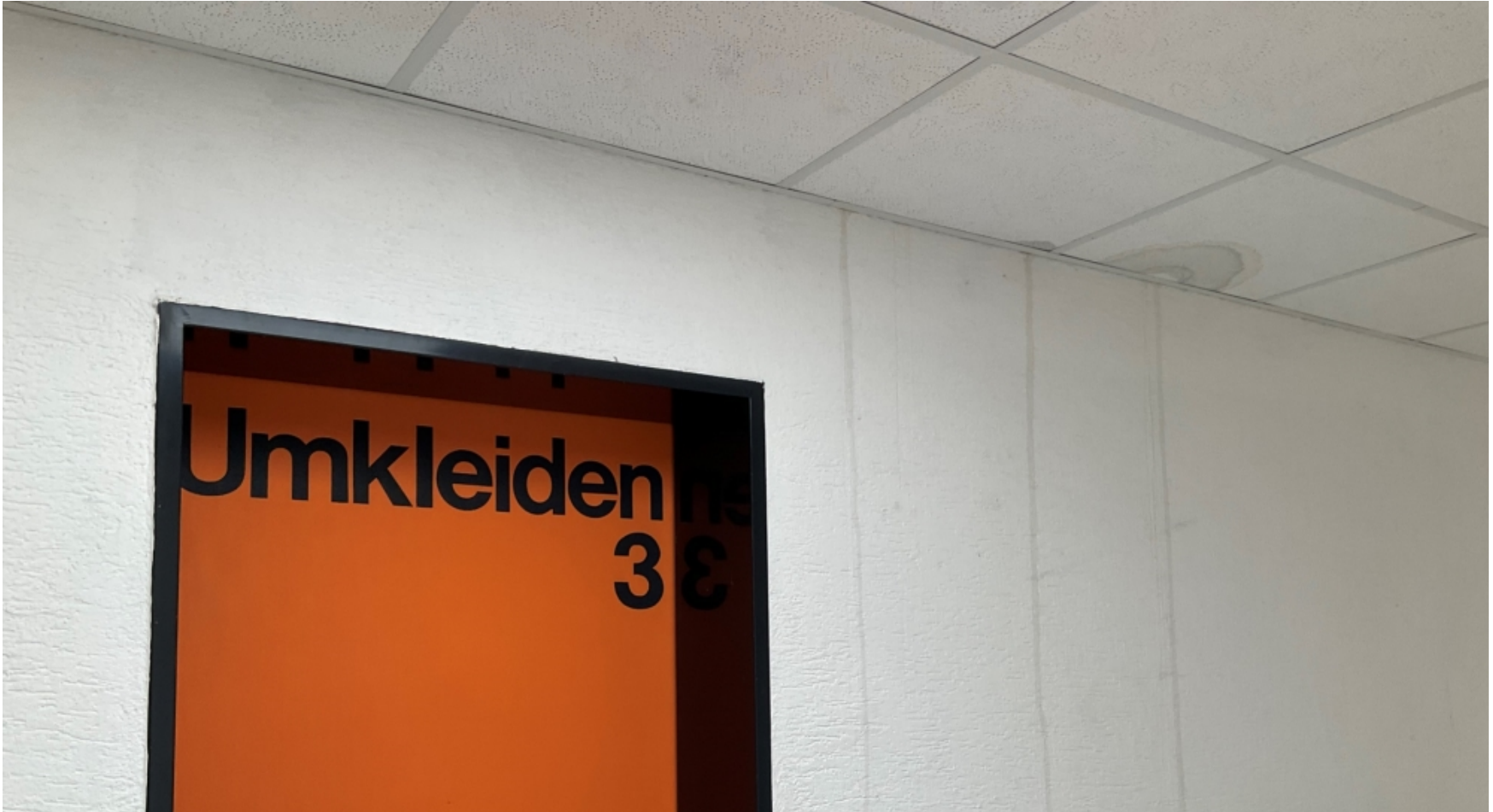
Flur vor Umkleide 3 mit Wassereintritt durch das Dach
