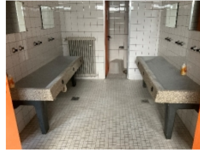
Veralteter Waschbereich angrenzend der Umkleiden
