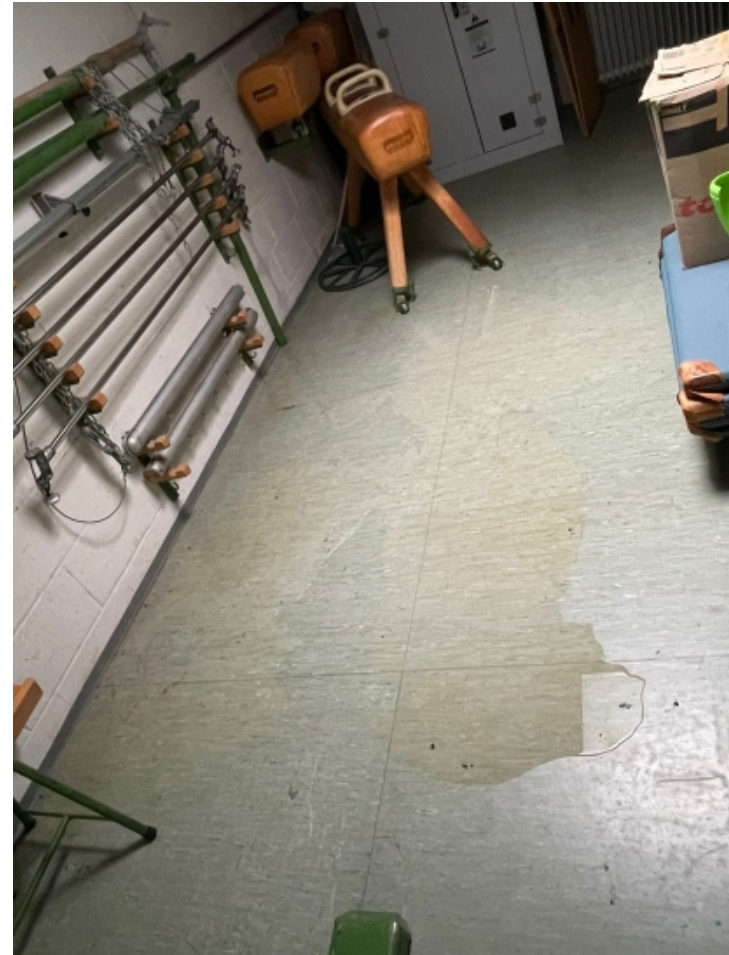
Von Regenwasser beeinträchtigter Geräteraum
