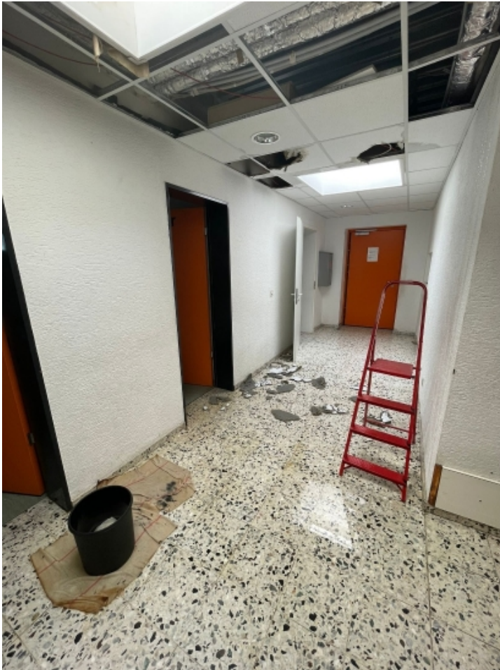
Flur mit Wassereintritt durch das Dach
