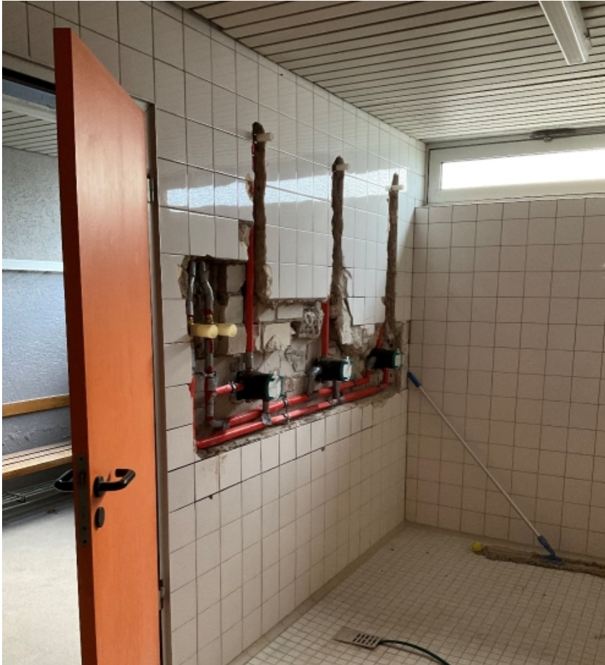
Dusche nach Wasserrohrbruch
