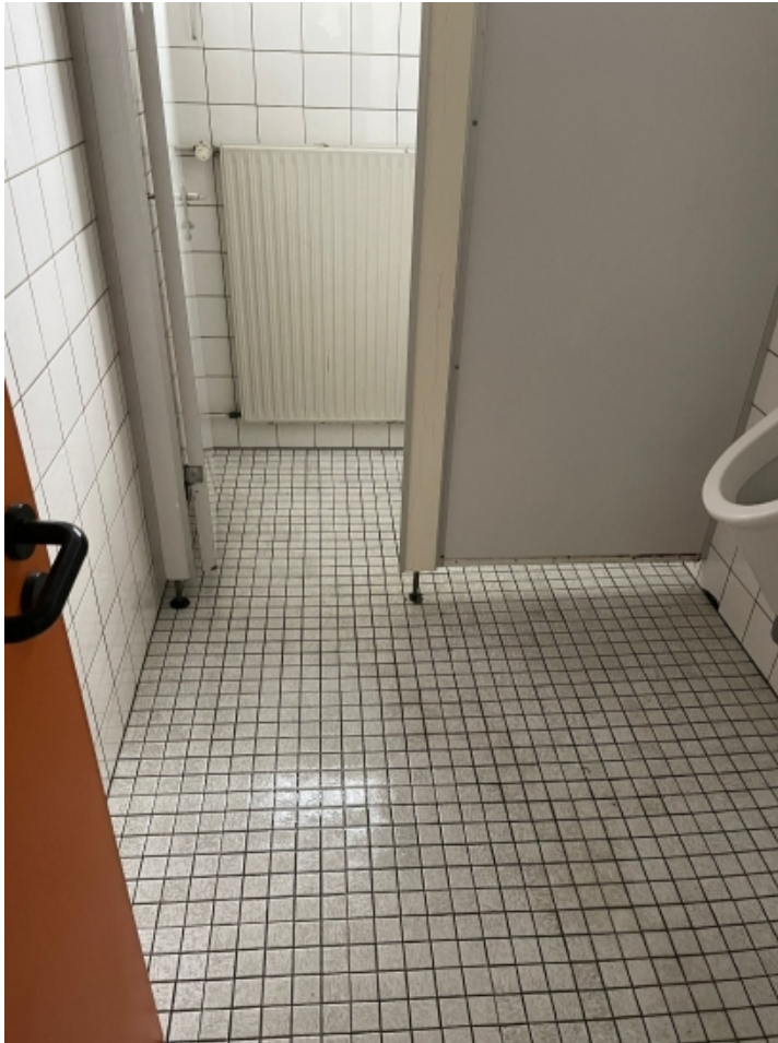
WC mit Wassereintritt durch das Dach
