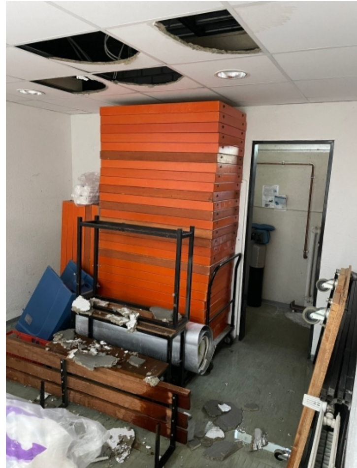
Garderobenbereich mit Wassereintritt durch das Dach
