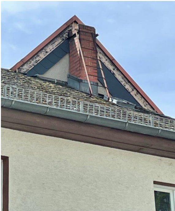
Giebelbretter (Nachbar) ohne Anstrich, Reinigung Dachfläche und Kontrolle notwendig
