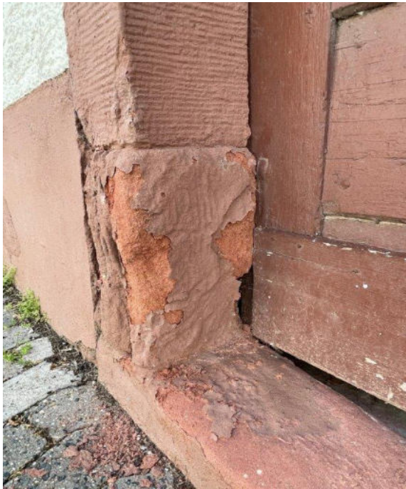
Weitere Nebentür EG, Fußbereiche Sandstein lösen sich auf, Schwelle defekt, keine Klimafunktion
