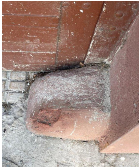
Abweise Ausbruchstellen, keine Schwelle, Tür ohne Klimafunktion
