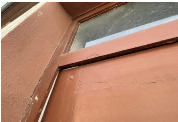
Türen schließen nicht, verzogen ohne Dichtung Keine Klimafunktion
