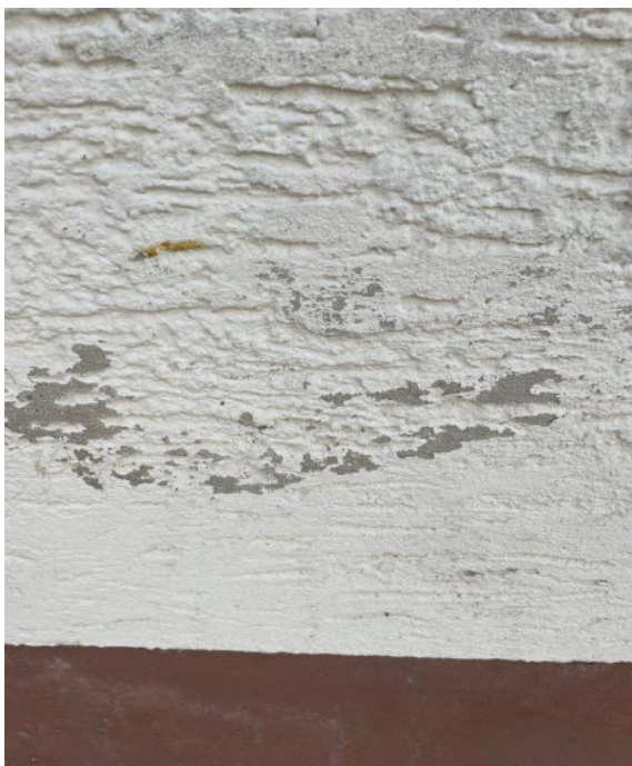
Putzfarbe blättert ab, Farbauftrag zu dünn, keine Horizontalsperre gegen Feuchtigkeit
