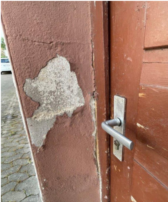
Türeinfassung Anstrich blättert ab, Sandsteinfassung evtl. zugeputzt
