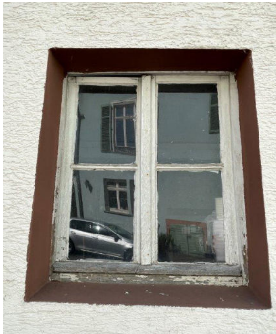
Alte Holzfenster, kein Wetterschutz mehr, Anstrich komplett abgeblättert
