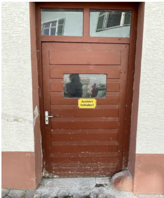
Weitere Nebentür EG, Fußbereiche Sandsteinblock beschädigt, keine Schwelle, keine Klimaklasse
