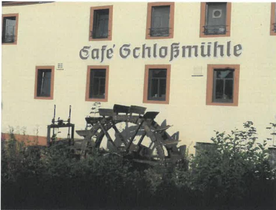
Abbildung 22: Das einst imposante Mühlrad an der Mümling ist aufgrund erheblicher Mängel nicht mehr funktionsfähig
