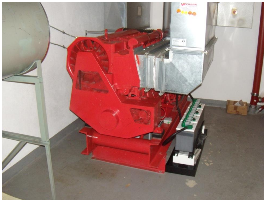
Abbildung 4 Die Netzersatzanlage (stationär) des Feuerwehrhauses in Korbach [4]
