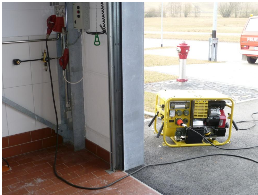
Abbildung 3 Einspeisung mit einem tragbaren Stromerzeuger über die Einspeisestelle in die elektrische Anlage des Feuerwehrhauses in Münchhausen [4]
