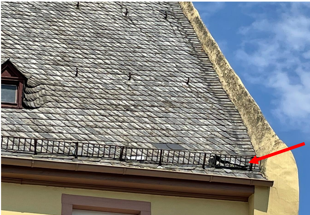
Abgestürzte Blechverwahrungen, Südost
