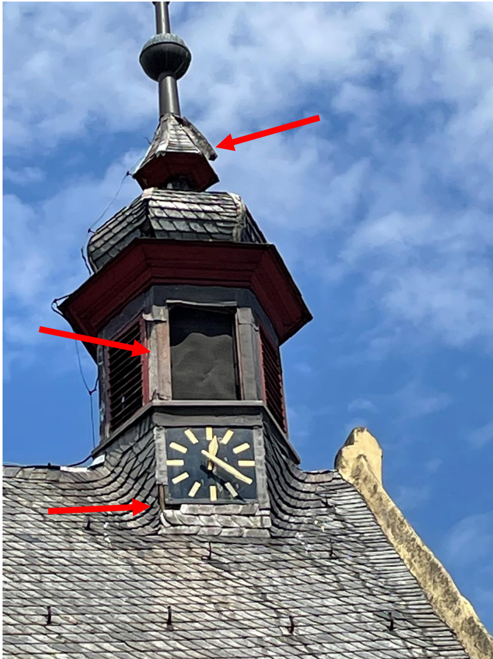
Fehlende bzw. abgängige Bleiverwahrungen und Decksteine, Südost
