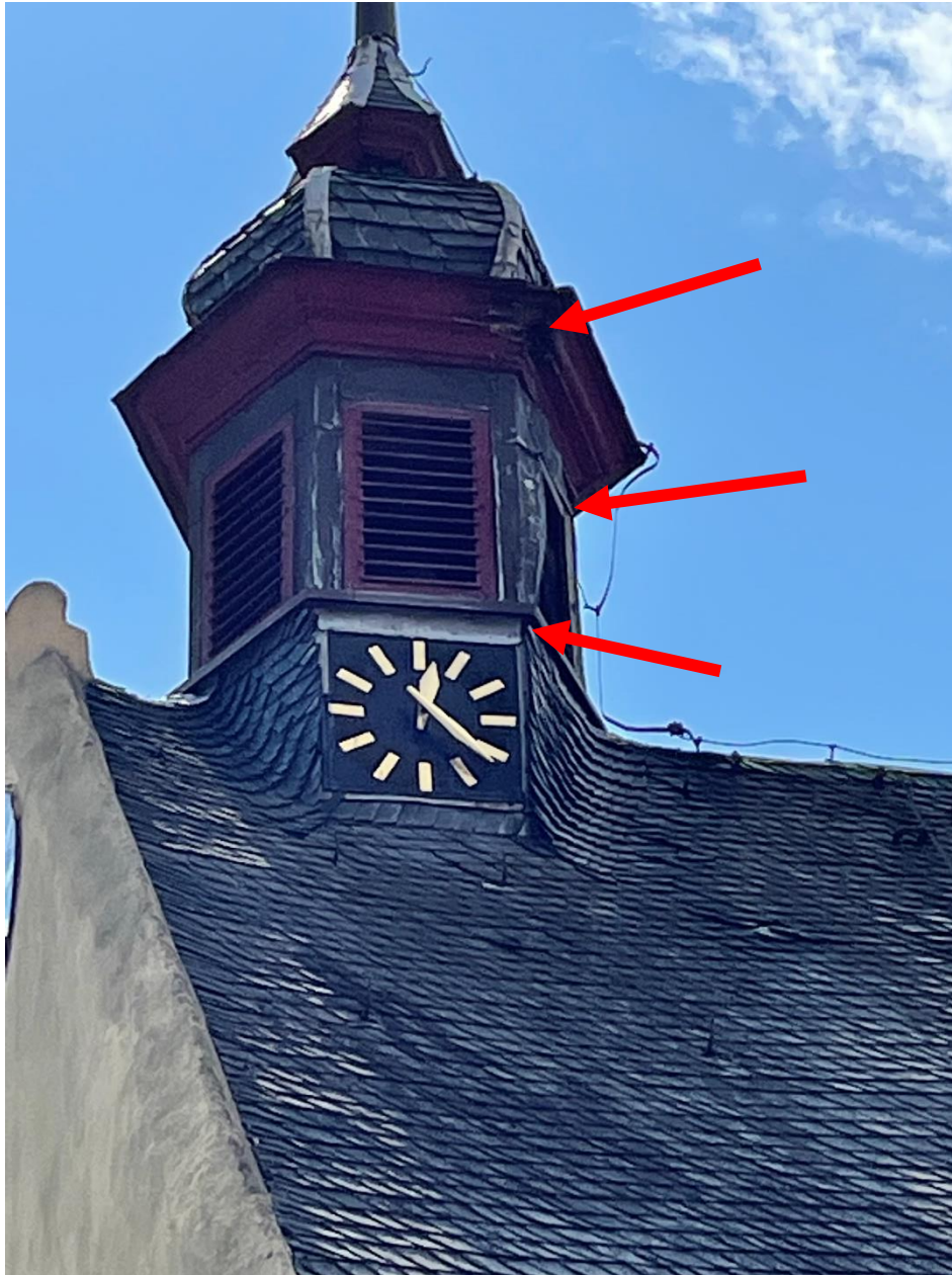
Schadhaftes Traufgesims, fehlende Bleiverwahrungen, Norden
