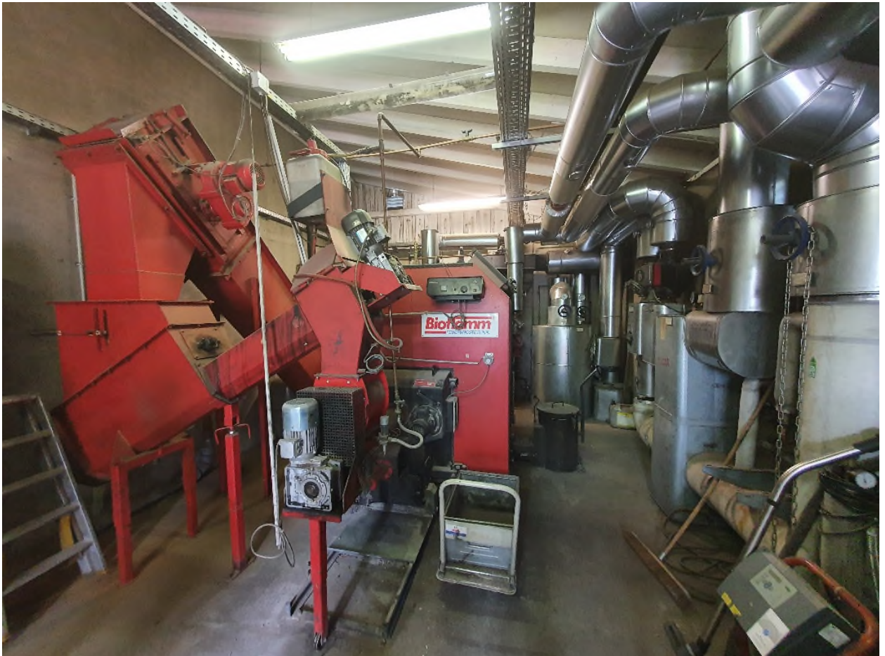
Ansicht 34: Exemplarisch: Hackschnitzelheizanlage in Schöffengrund, aufgenommen am 8. Juni 2021
