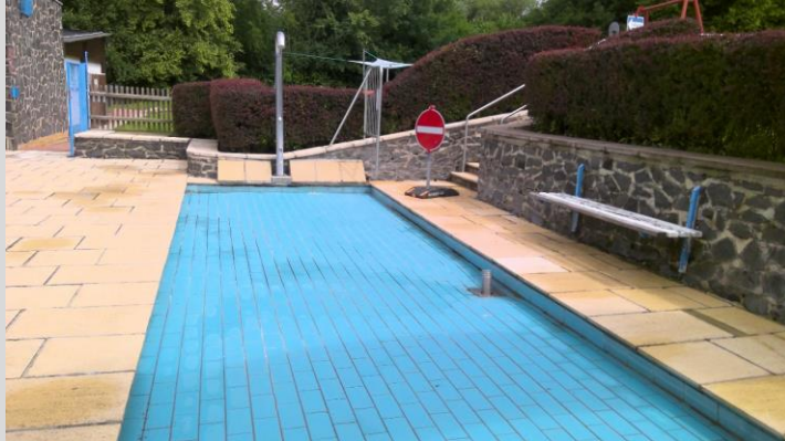
Durchschreitebecken und Zugänge nicht barrierefrei
