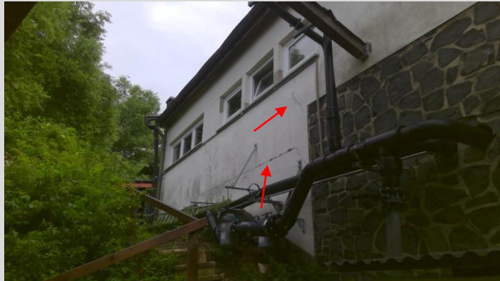
Setzungsriss Schwimmeistergebäude/ Technik
