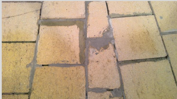
Plattenbeläge mit vielen Mängeln (Risse, Überstände, etc.)
