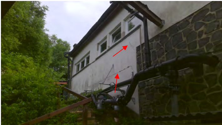
Schwimmmeisteraufsicht mit starken Setzungsrisse außen
