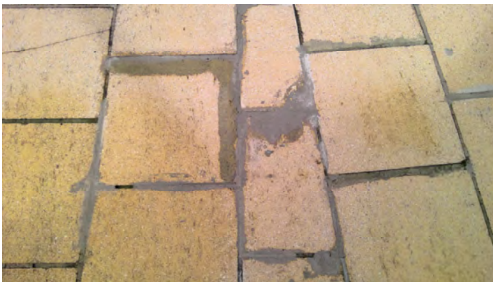
Beckenumgangsbelag aus Natursteinplatten mit Rissen, breiten Fugen und Höhenversätzen
