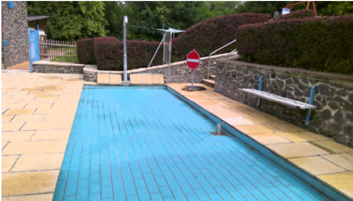
Mängel an Fliesen und Platten aufgrund Frosteinwirkung
