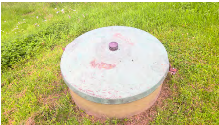
Vorhandene Schwallwasserbehälter aus GFK – nicht mehr zulässig
