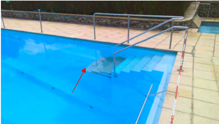
Treppengeländer nicht normgerecht, Rastpodest nicht vorhanden
