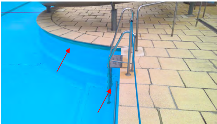
Tiefliedende Überlaufrinne, Toleranzen außerhalb der Norm, keine Leiternischen
