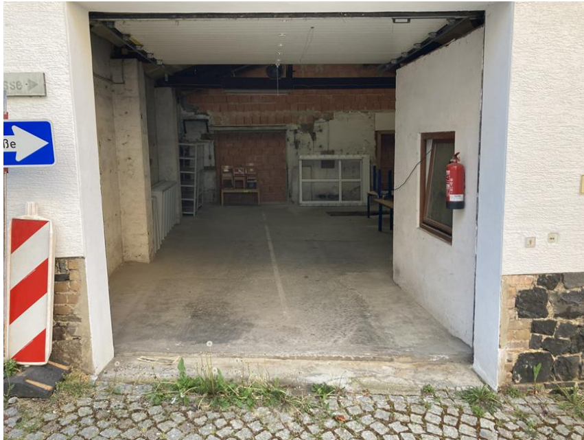
Abbildung 3: Gefälle von links nach rechts im Bestandsgebäude
