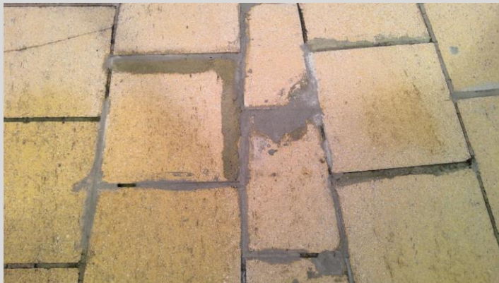
Plattenbeläge mit vielen Mängeln (Risse, Überstände, etc.)
