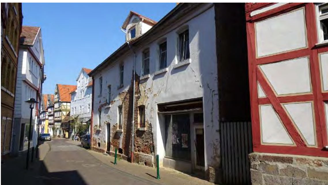
Abbildung 22: Alte Brauerei in der Untergasse – Gebäude mit erheblichem Sanierungsstau
