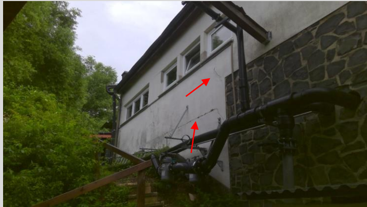
Setzungsriss Schwimmeistergebäude/ Technik
