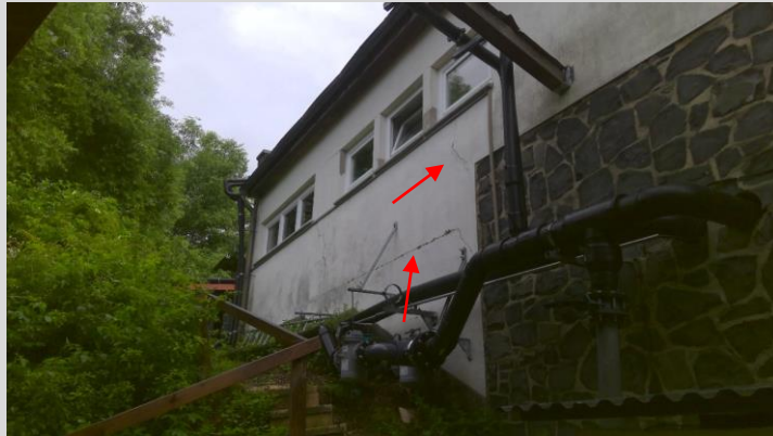
Setzungsriss Schwimmeistergebäude/ Technik
