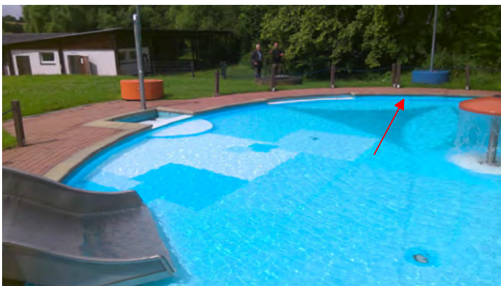
Keine umlaufende Rinne, keine Wasserführung → insgesamt nicht sanierungsfähig
