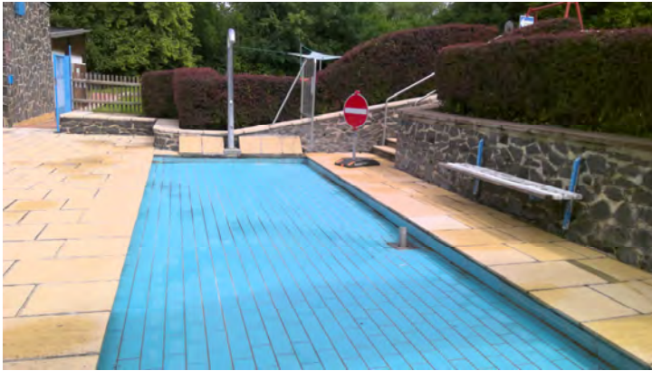
Mängel an Fliesen und Platten aufgrund Frosteinwirkung
