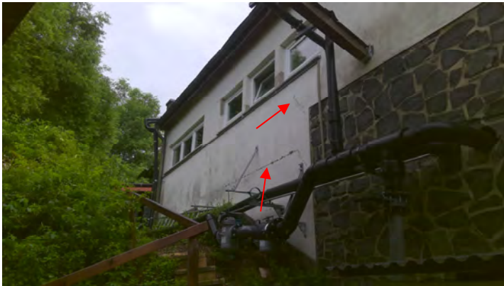
Schwimmmeisteraufsicht mit starken Setzungsrisse außen
