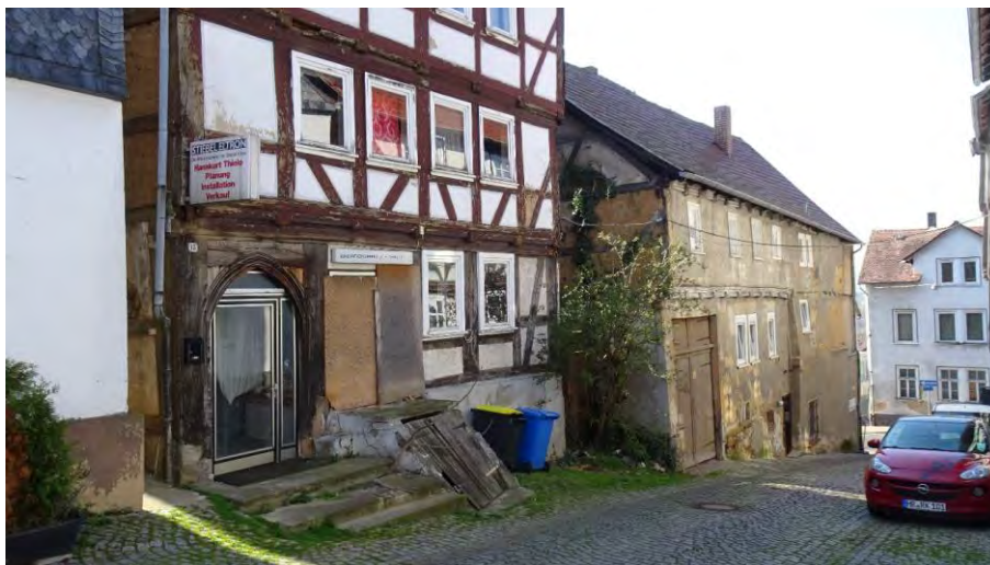
Abbildung 24: Wohngebäude mit Anbau für Handwerk mit erheblichem Sanierungsstau
