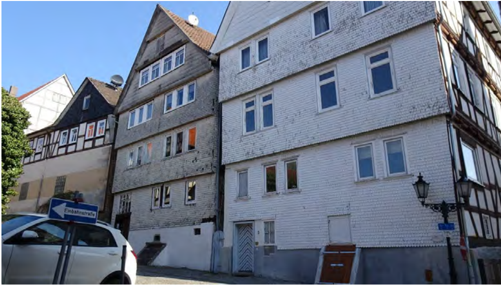
Abbildung 25: Wohnhäuser mit erheblichem Sanierungsstau
