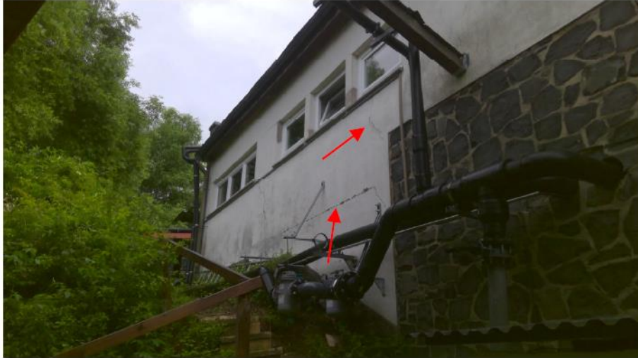
Schwimmmeisteraufsicht mit starken Setzungsrissen außen
