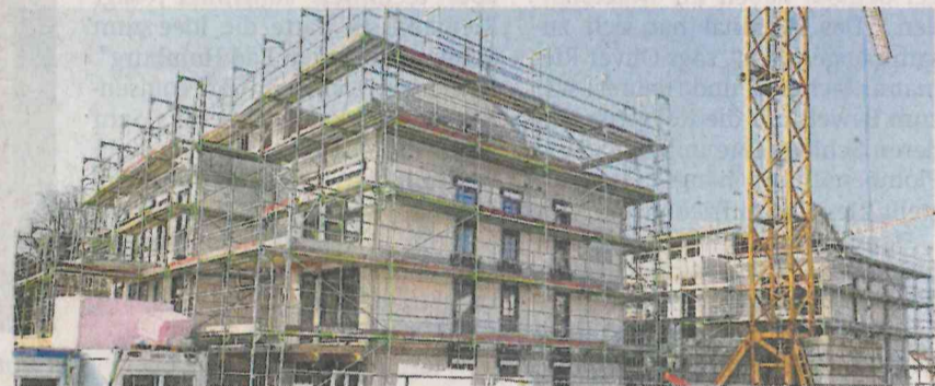
Die Solitäre Am Hühnerstein (Ober-Erlenbach) wurden im Juni fertig. Ihr Bau wäre heute viel teurer. FOTO: HKO
