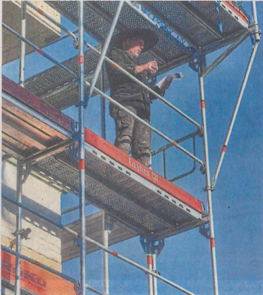
Auf der Baustelle in der Friedensstraße in Oberhöchststadt erklang im Winter der Richtspruch. Die OWG hat dort 60 Wohnungen errichtet. FOTO: ÖP
