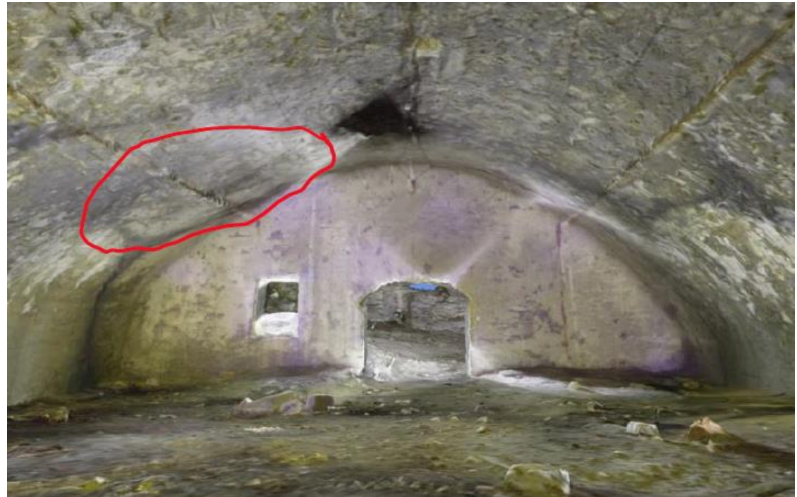
Verformung des Gewölbes (Auszug 3D-Modell – Bauteil 3.1)
