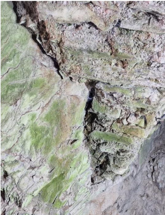
Riss am Bogenaufleger (Bauteil 12)
