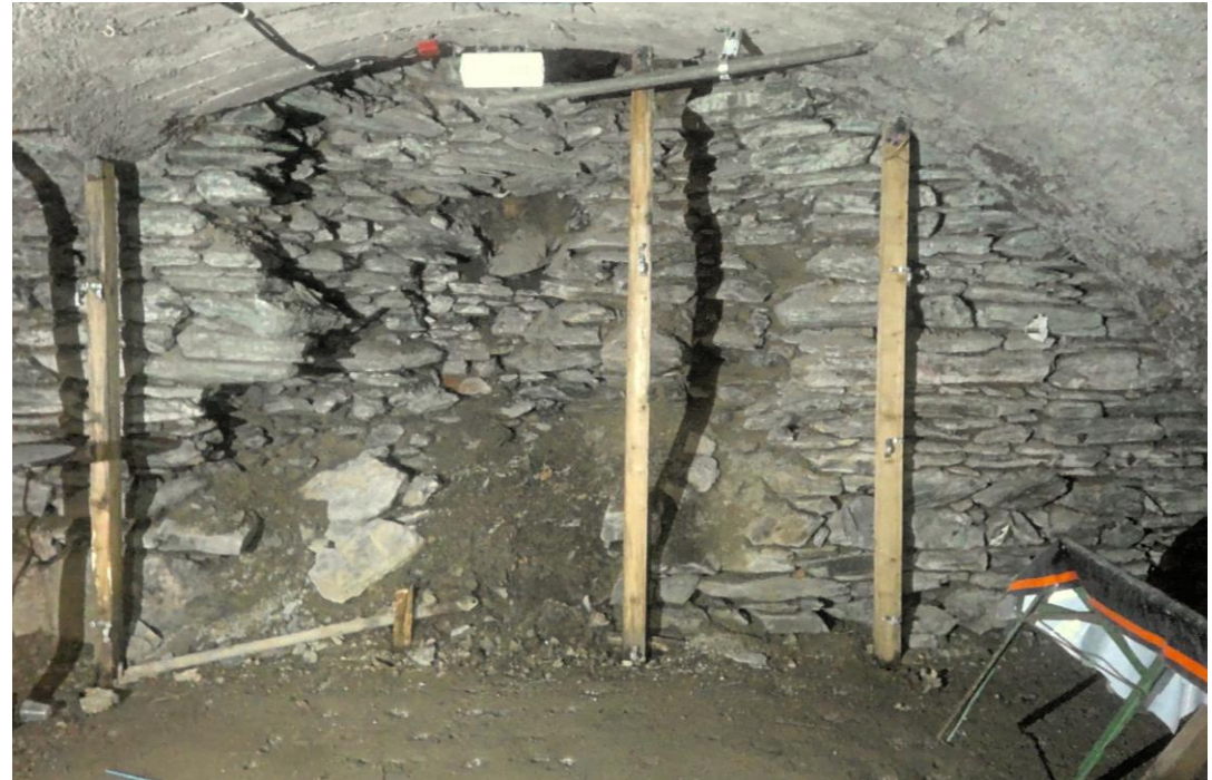
Einsturzstelle Schildwand (Bauteil 16)
