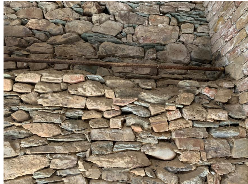
entfestigtes Mauerwerk aufgrund fehlender Verfugung (Bauteil 19)
