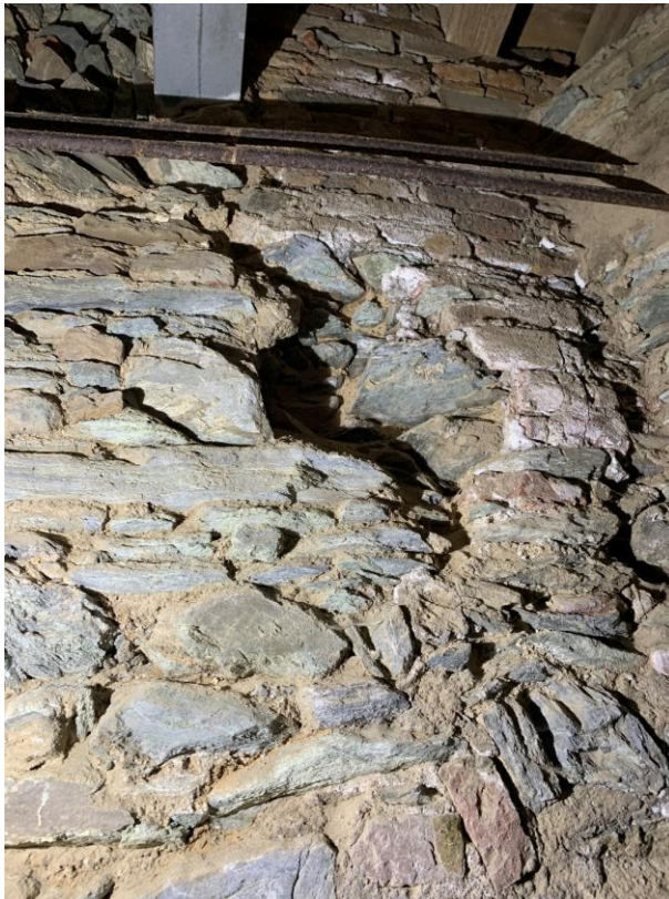
Ausbauchung / Ausbruchstelle (Bauteil 19)
