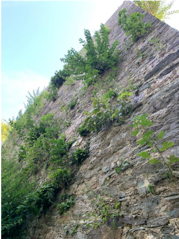
großflächig durchholzender Bewuchs (Bauteil B.4)
