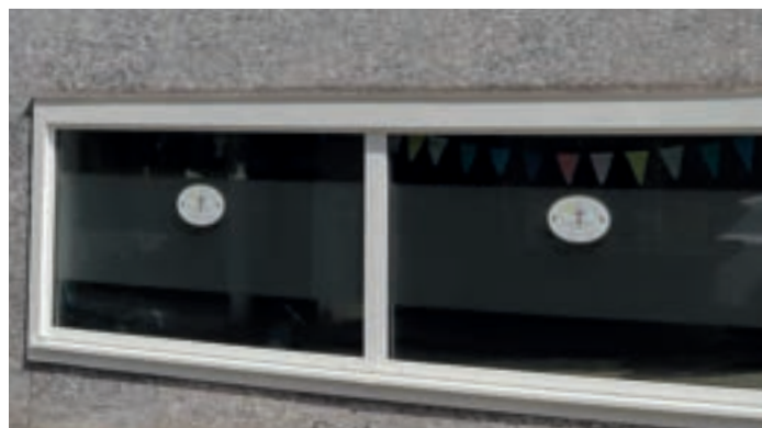
gestörte Fassade, fehlende Untergliederung, liegendes Format
