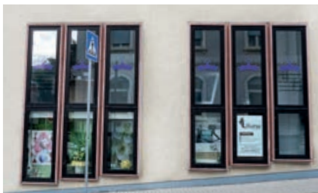
gestörte Fassade, geschossübergreifend
