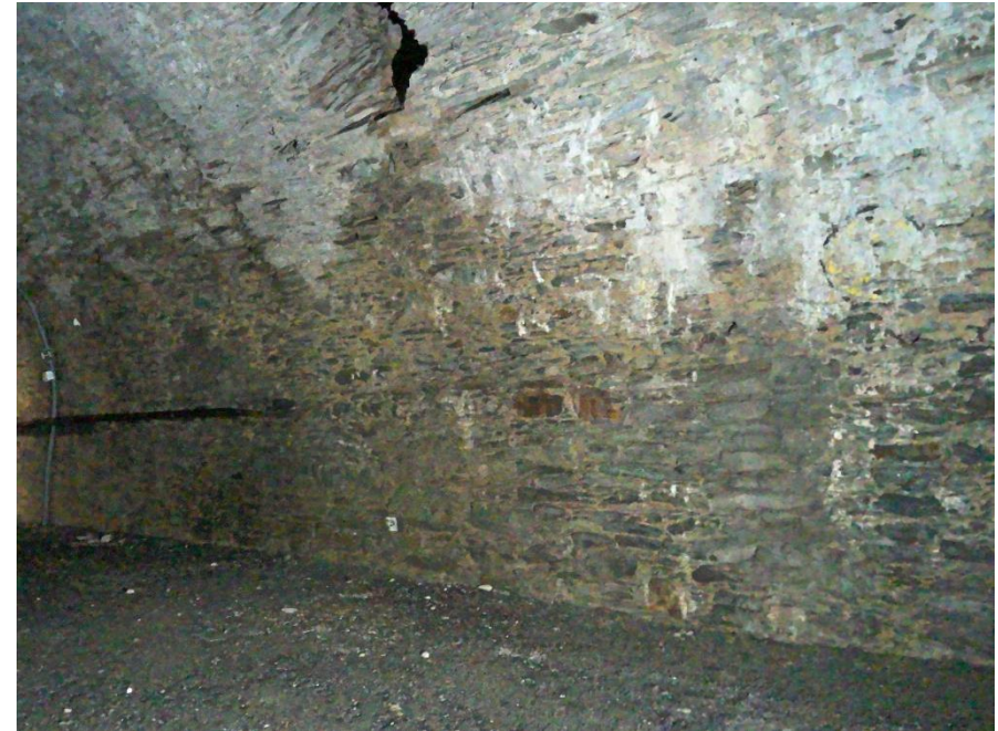
Durchfeuchtetes Mauerwerk, Aussinterungen Bauteil (Bauteil 13)
