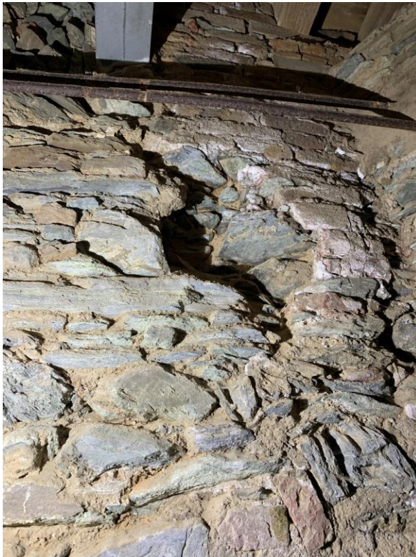
Ausbauchung / Ausbruchstelle (Bauteil 19)
