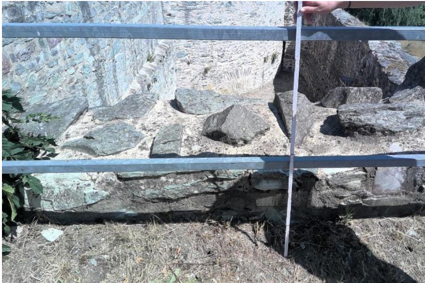
Überkletterbarkeit unzureichende Geländerfüllung (Bauteil H.5)
