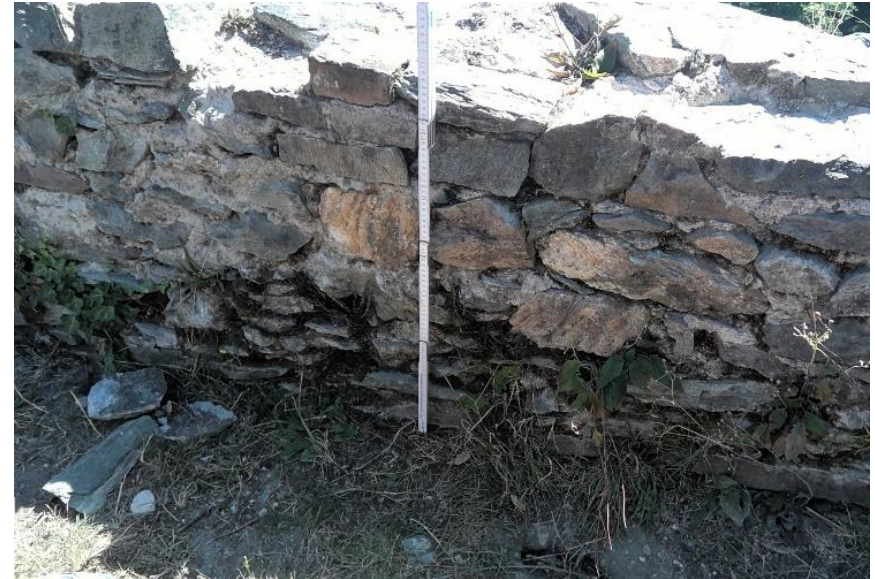
Überkletterbarkeit, unzureichende Brüstungshöhe (BRH = 70 cm) (Bauteil H.1)
