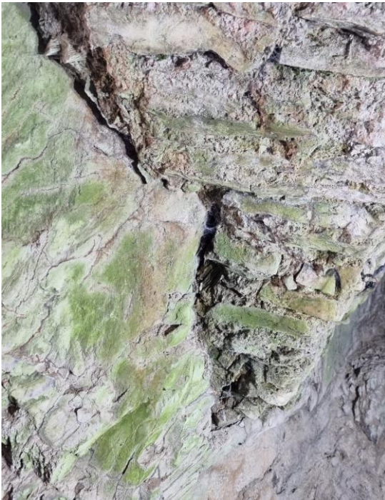
Riss am Bogenaufleger (Bauteil 12)
