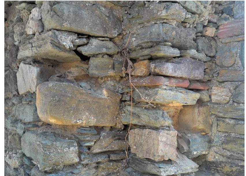
entfestigtes Mauerwerk aufgrund zurückgewitterter bzw. fehlender Verfugung (Bauteil J.4)
