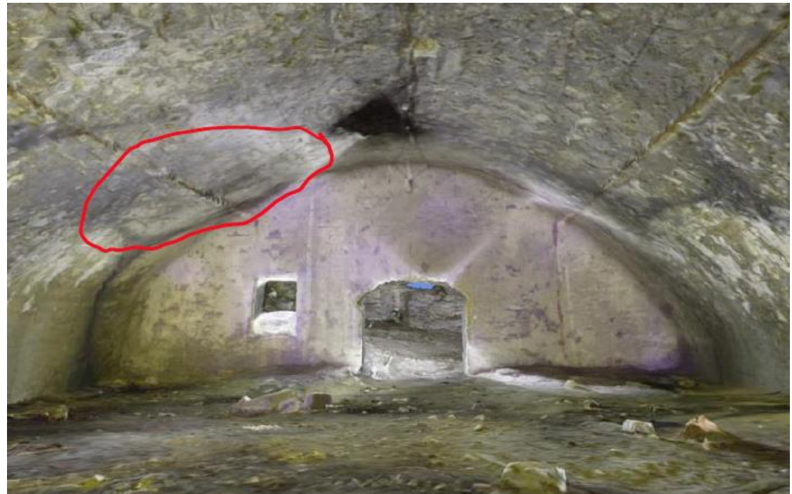
Verformung des Gewölbes (Auszug 3D-Modell – Bauteil 3.1)
