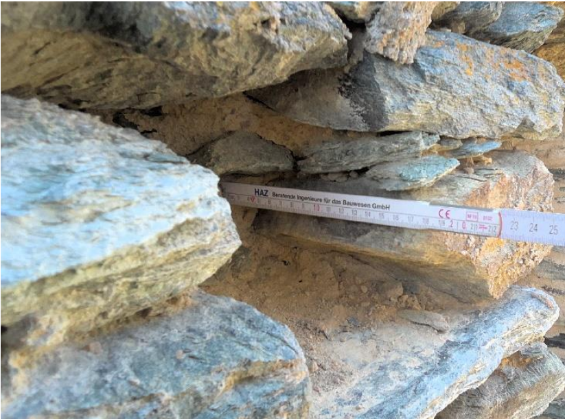
Fehlstellen und entfestigte Steine aufgrund zurückgewitterter bzw. fehlender Verfugung (Bauteil J.4)
