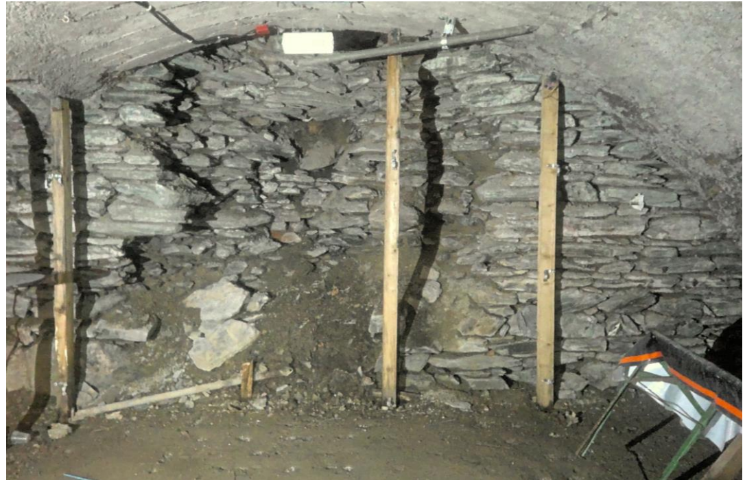
Einsturzstelle Schildwand (Bauteil 16)
