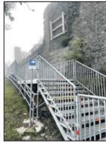
Sicherer als bei anderen Fessen auf der Burg: Die Böschung zum oberen Burghof wird während Halloween überdeckt. In der Einbahnverengung wird es hier nur herab gehen.
