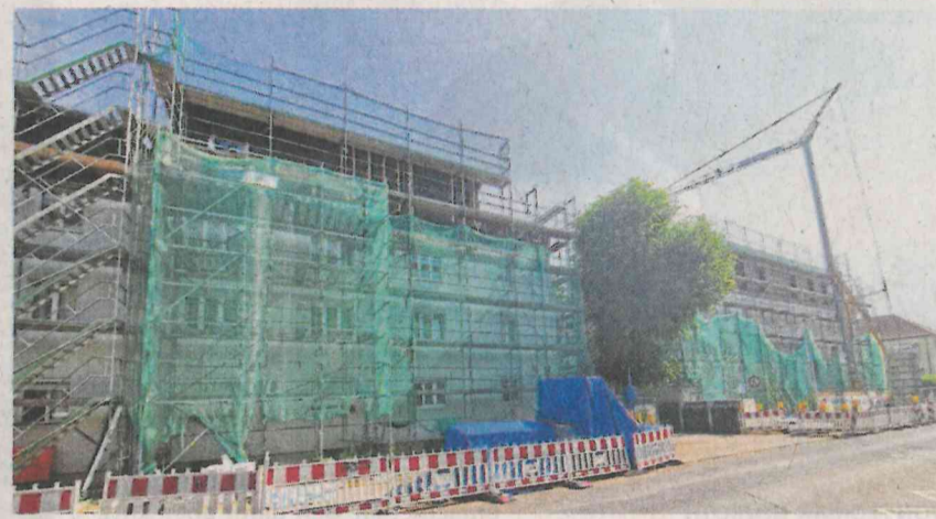
Derzeit letztes Projekt der Hochtaunus Baugenossenschaft: Aufstockung in der Jacobistraße Bad Homburg; ein Bild aus diesem Sommer. FOTO: HKO
