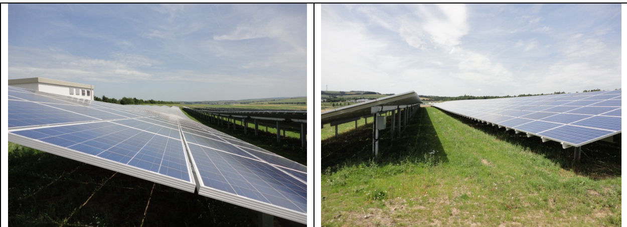
Bild 1: In Betrieb befindliche Anlage
