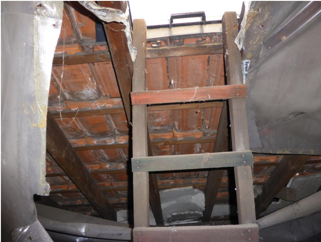
Abb. 9: Fehlende Teile der Isolation, Fenster verglast, auch hier keine Einflugmöglichkeit
