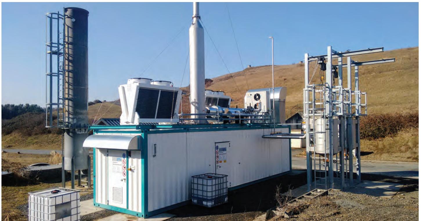
Abb. 6: Das 2016 erneuerte Blockheizkraftwerk (BHKW) zur Deponiegasverwertung. Das BHKW wird vom Abfallwirtschaftsbetrieb ab 2017 in Eigenregie betrieben.
