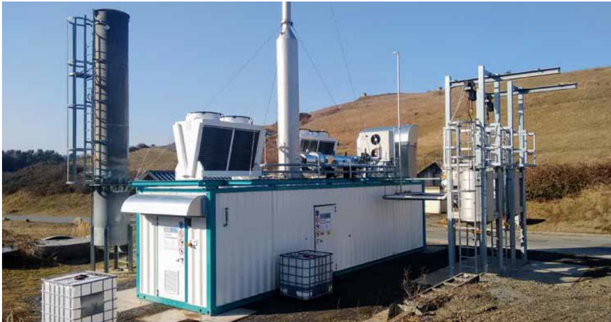
Das 2016 erneuerte Blockheizkraftwerk (BHKW) zur Deponiegasverwertung. Das BHKW wird vom Abfallwirtschaftsbetrieb seit 2017 in Eigenregie betrieben
