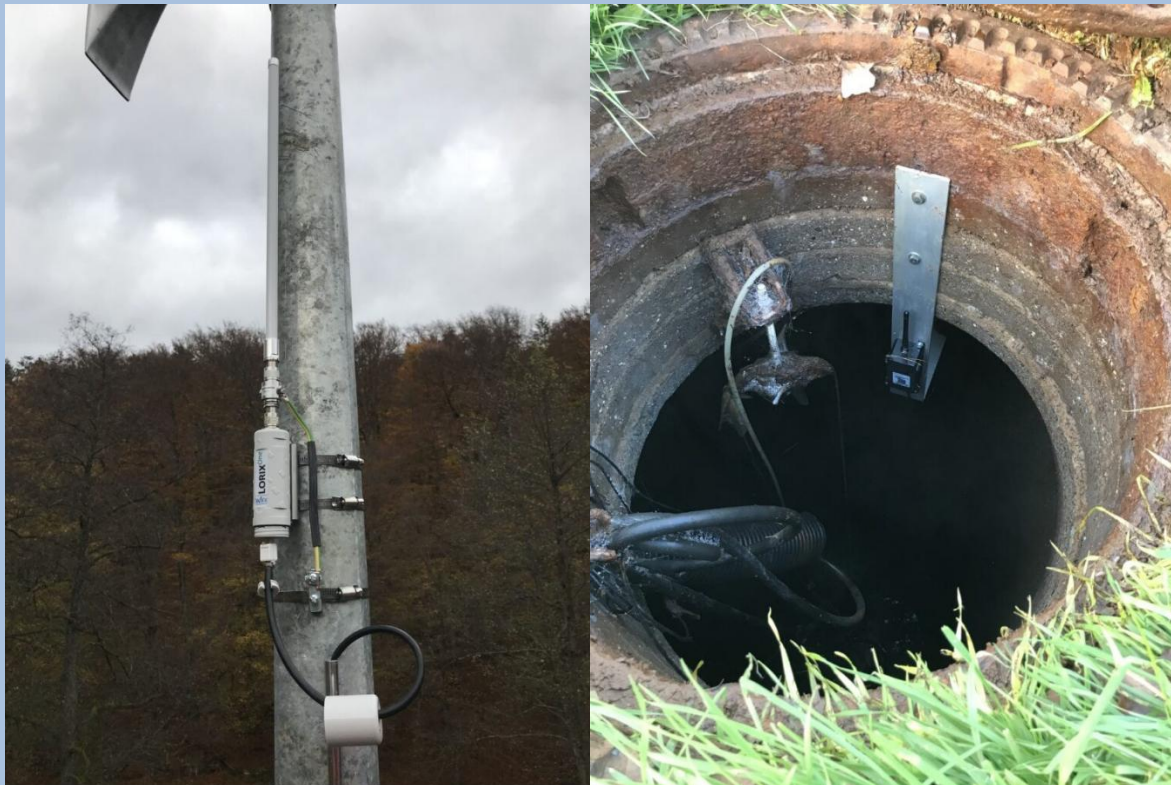
Ansicht 30: Gateway (links - Aufnahme vom 16. November 2022) und Pegelmesser Abwasserschacht (rechts - Aufnahme vom 25. August 2025) Gemeinde Gründau
