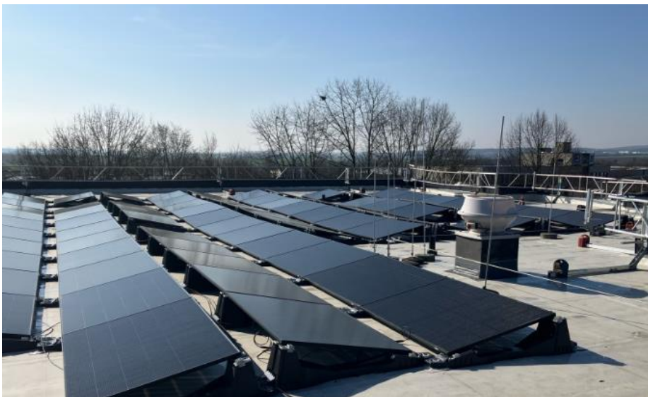
Abbildung 48: Neue PV-Anlage der JVS
