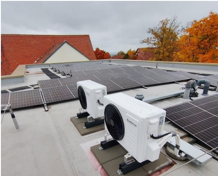
Abbildung 47: Neue PV-Anlage der HSS Homberg
