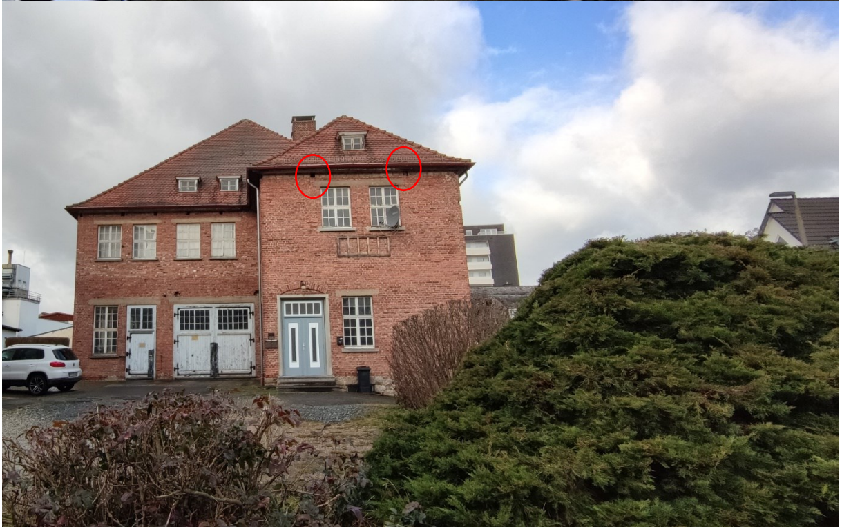
Abbildung 2 & 3) Backsteingebäude mit Spalten (rot umrandet)
