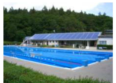
Abb. 3: Thermische Solaranlage Waldschwimmbad 4
